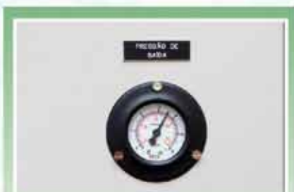
Manômetro indicador da pressão de saída de água gelada para melhor controle do processo.
