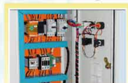
Painel Elétrico com grau de proteção IP54. Disjuntor, contator e relé térmico de proteção.
